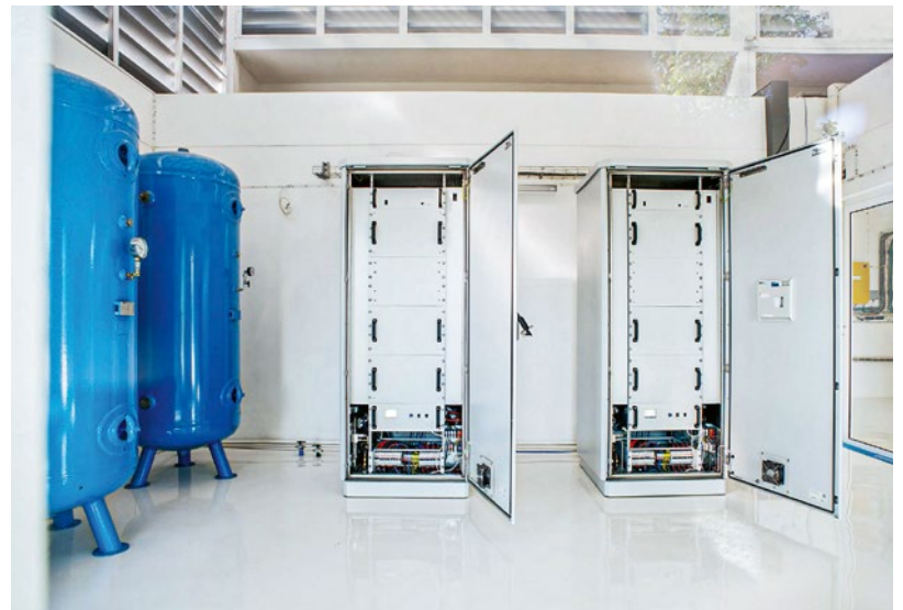
Die Elektrolyseure können nach Bedarf zu größeren Anlagen kombiniert werden.
