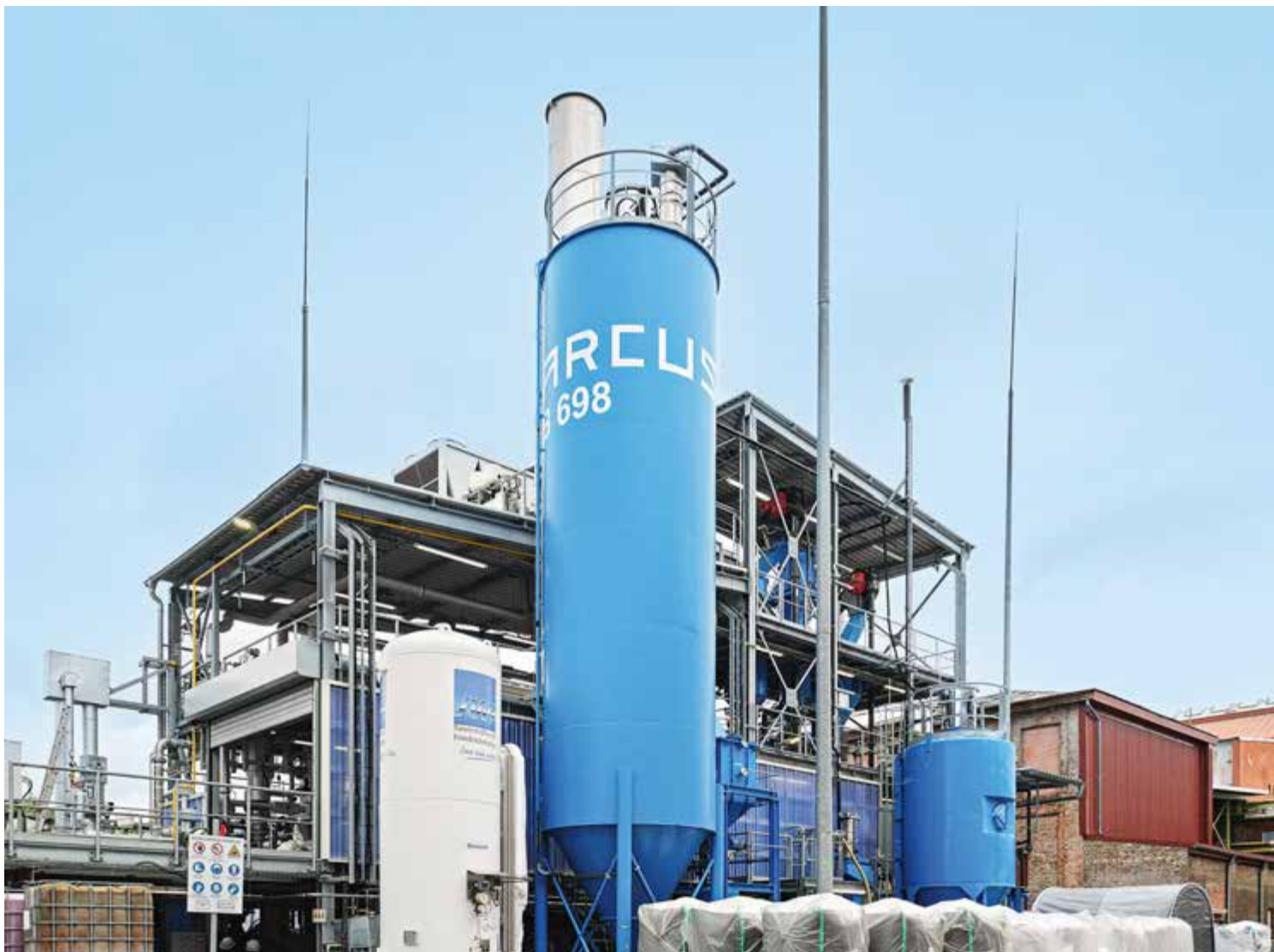
Chemisches Recycling in Betrieb: die Pyrolyseanlage von Arcus Greencycling in Frankfurt-Höchst
